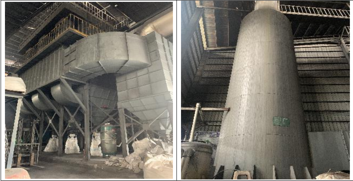
图 4-4 废气治理区照片
