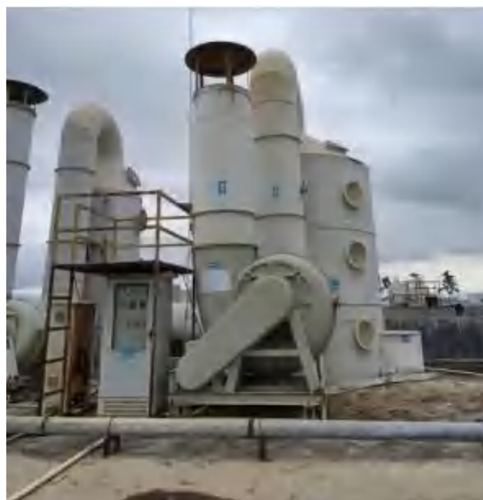
废气处理设施
